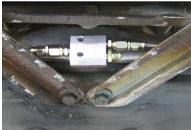
Verteiler geklebt / T-splitter adhere
